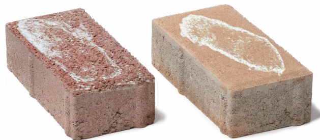
Dlažba s výkvětem
