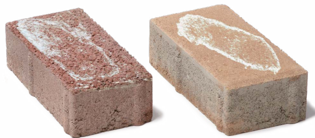
Dlažba s výkvětem
