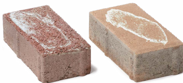
Dlažba s výkvětem
