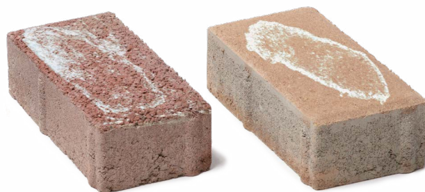
Dlažba s výkvětem
