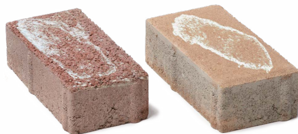
Dlažba s výkvětem
