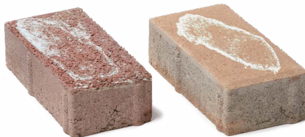
Dlažba s výkvětem
