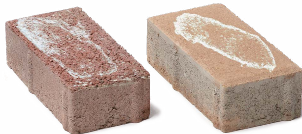
Dlažba s výkvětem
