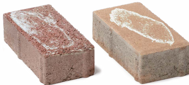
Dlažba s výkvětem
