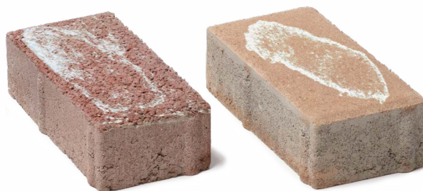
Dlažba s výkvětem
